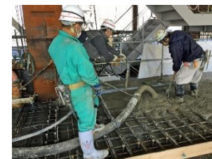
【圧送ポンプを利用して型枠内にコンクリートを打ち込むところ】
